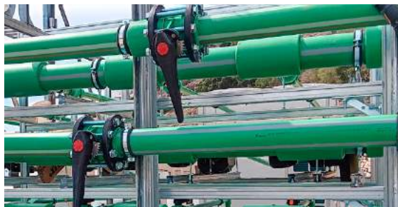
Instalación ACS, España. / ACS installation, Spain.
