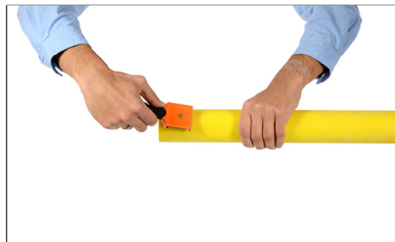
5. Rascar la zona de soldadura del tubo. Scrap the welding zone of the pipe.
